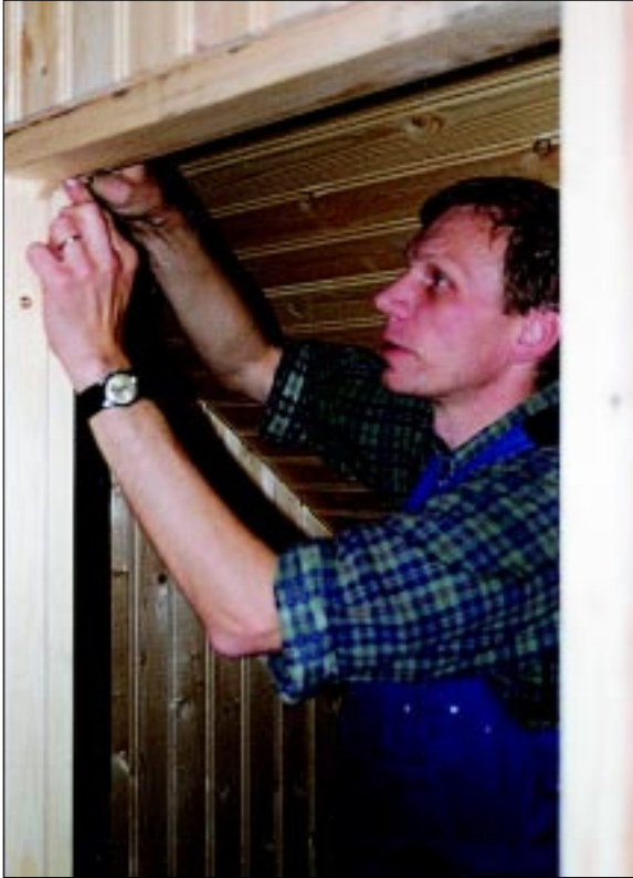
Mynd 24. Gunnar Bjarnason gengur frá dyrastöfum á lofti Nýjahúss síðsumars 1997. Ljós. Þór Hjaltalín.
