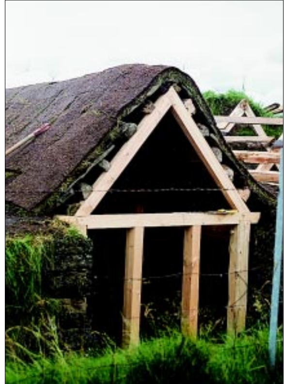
Mynd 17. Þekja hefur verið sett á smiðjuna. Ofan á sperrunum liggja raftarnir, síðan hellurnar og nærtorfið. Ofan á nærtorfið var settur vatnsvarnardúkur og þrefalt torflag. Ljós. Þór Hjaltalín.
