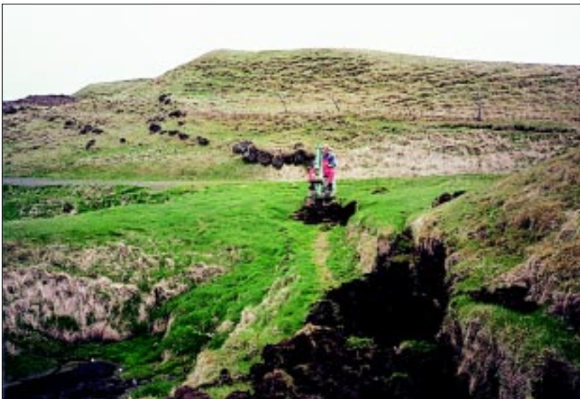
Mynd 2. Vorið 1997. Traðirnar voru uppgrónar en Skúli Lýðsson minnst þess að í æsku hans hafi þær verið akfærar Willysjeppa. Ari og Unnsteinn hófu verkið á því að grafa upp úr þeim. Á myndinni má sjá Unnstein nota litla skurðgröfu við það verk. Ljós. Ari Jóhannesson.
