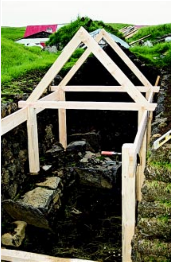
Mynd 12. Lokið var við að reisa grind smiðjunnar þann 19. ágúst 1997. Nokkur umræða átti sér stað um það hvort miðbitinn, sem hér sést á myndinni hafi verið þar upphaflega. Ljós. Þór Hjaltalín.
