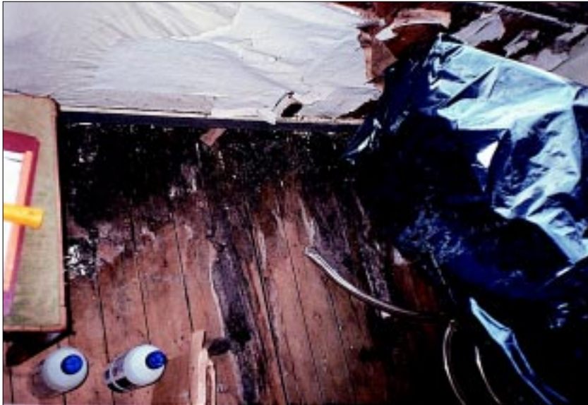
Mynd 32. Gólfborðin voru sumstaðar illa farin, sérstaklega upp við vegg. Ljós. Þórhallur Hólmgeirsson.
